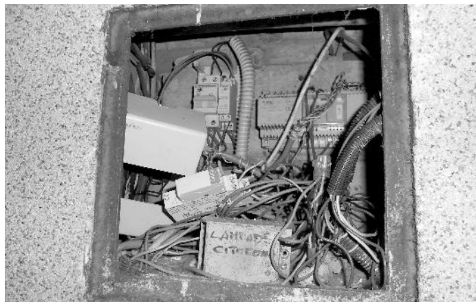
Un tentativo di quadro elettrico in un vano scala: aspettando l'incidente
