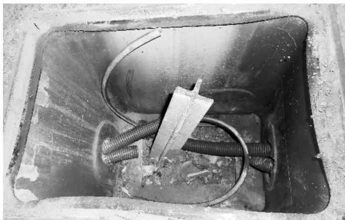
Conduttore di terra lasciato disconnesso per anni, in attesa di collegarlo "domani"
